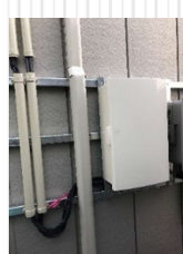
8 電力配線壁付
