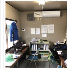
室内電気機器
